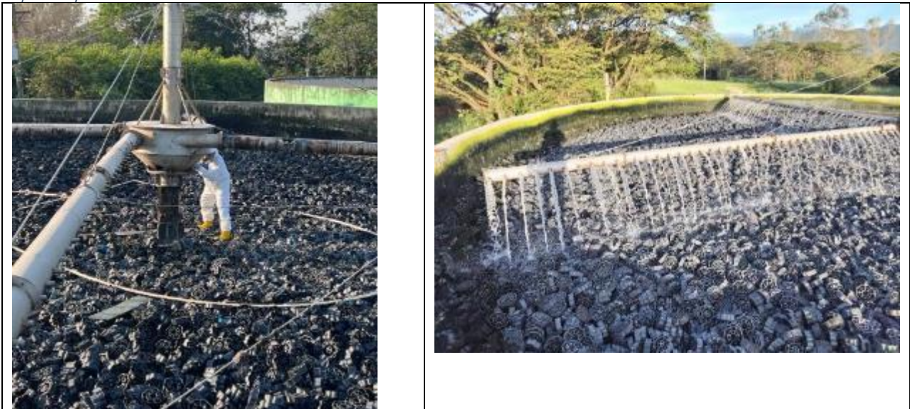
Ilustración 42 Mantenimiento preventivo tres veces por semana que incluye la limpieza de residuos que obstruyen los orificios de las flautas.
