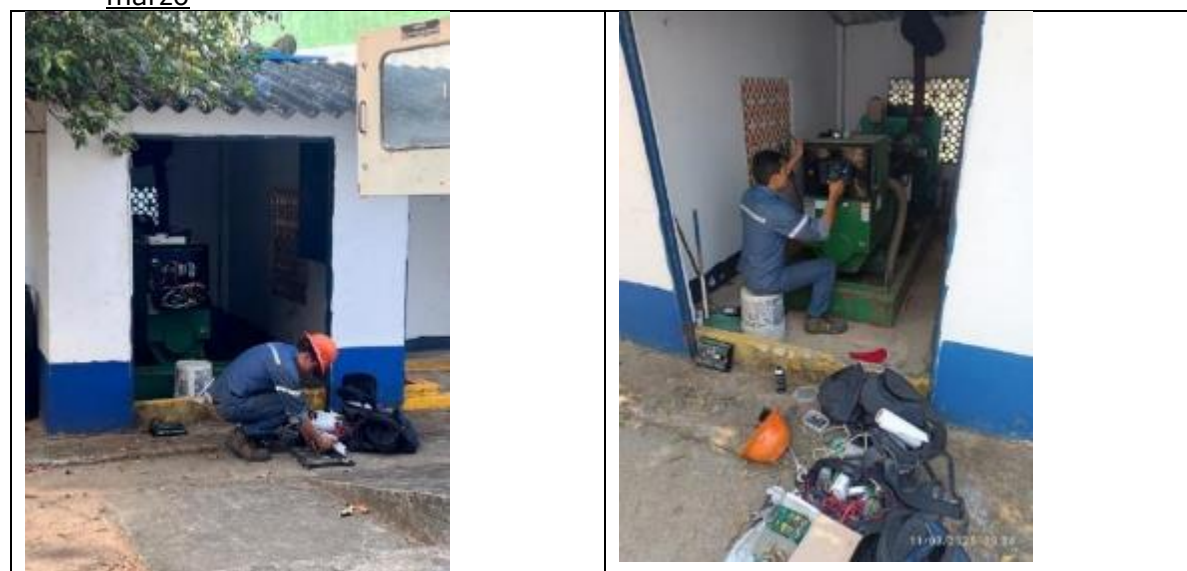
Ilustración 27 Mantenimiento del grupo electrógeno
