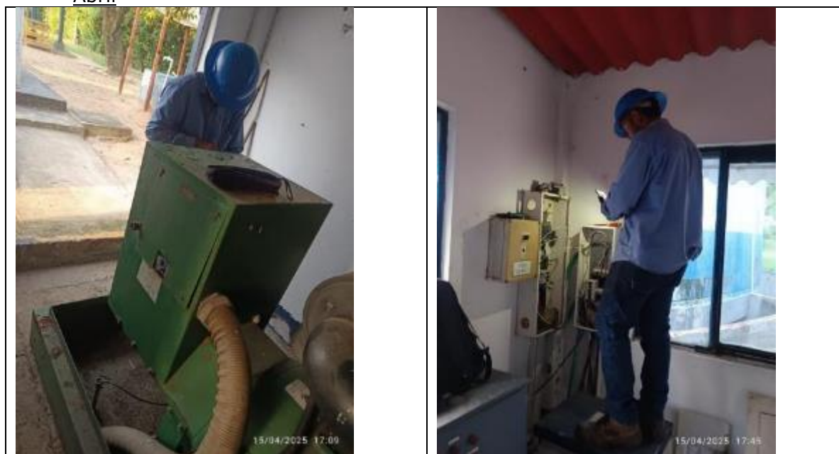
Ilustración 28 Mantenimiento del grupo electrógeno
