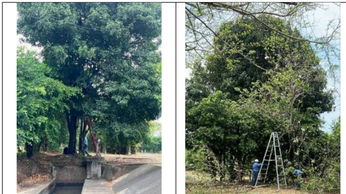
Ilustración 23 Poda de árboles que intervienen las redes electricas internas
