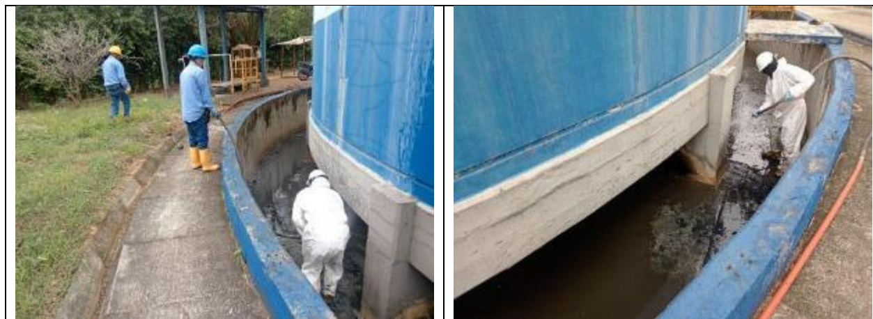
Ilustración 43 Limpieza de bandejas inferiores de los filtros con apoyo del equipo de succión-presión
