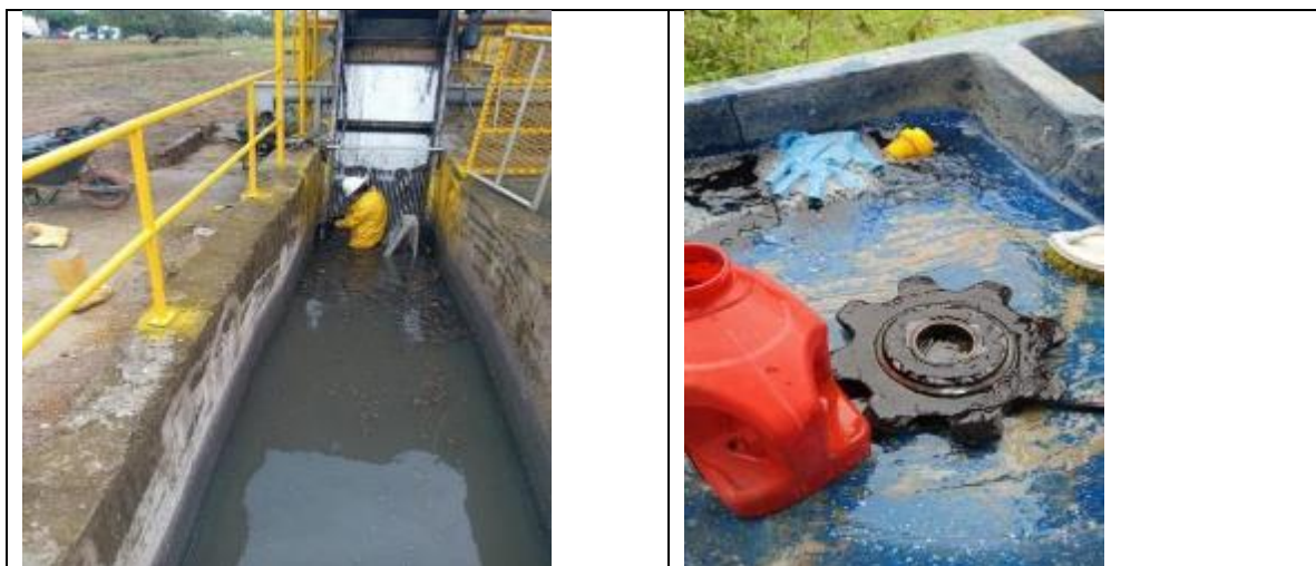
Ilustración 37 mantenimiento correctivo sistema autolimpiante 2
