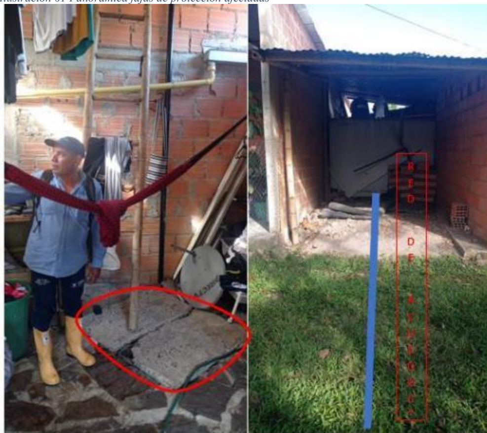
Ilustración 62 Casa construida encima de caja de válvulas y redes de acueducto 250 mts antes de la escuela la Guamalera Coordenadas 5°25'19.48"N 72°26'46.80"O
