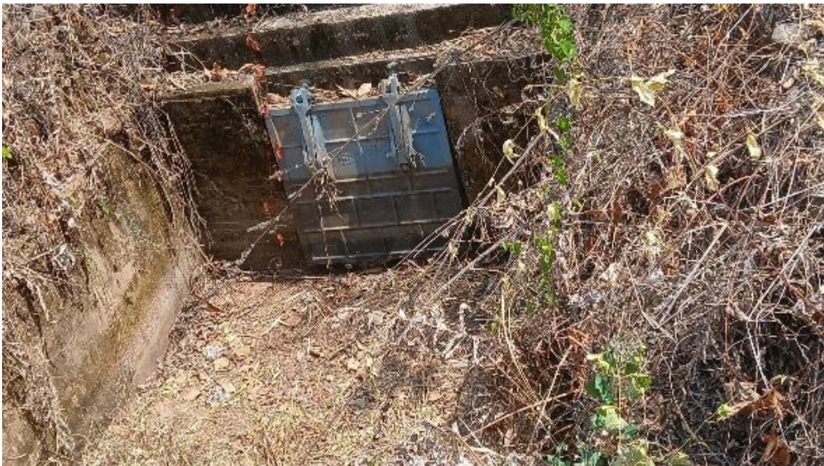
Foto 6 Estado actual cabezal de descarga - válvula chapaleta
