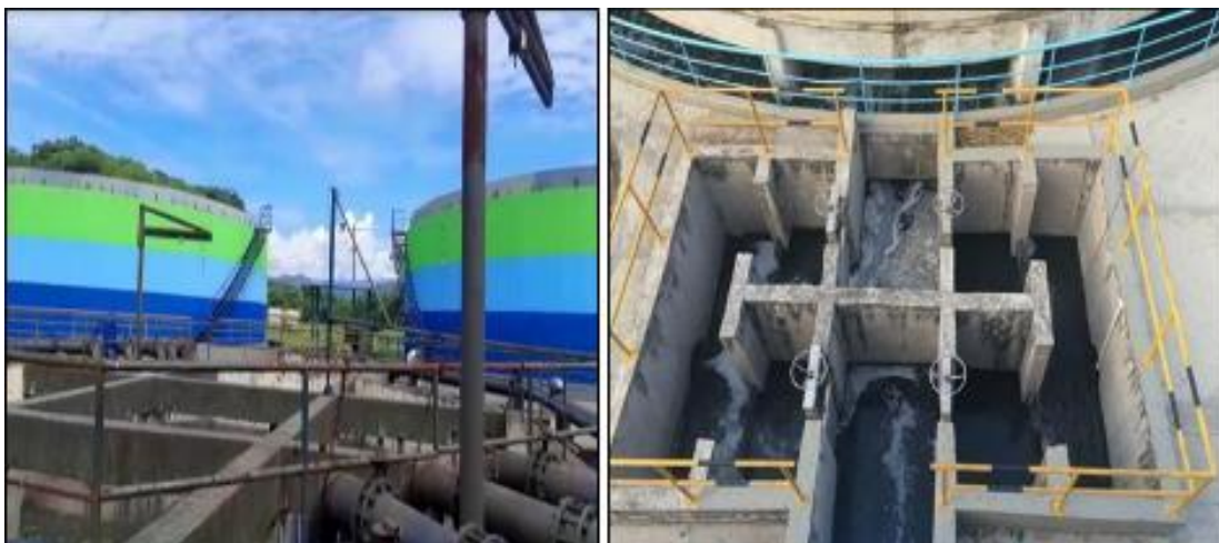
Foto 4 Filtros percoladores y cámara de recirculación
