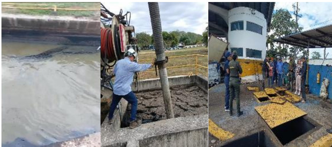
Foto 16 Vertimiento ilegal al sistema de alcantarillado- acompañamiento CORPORINOQUIA 14-01.2026
