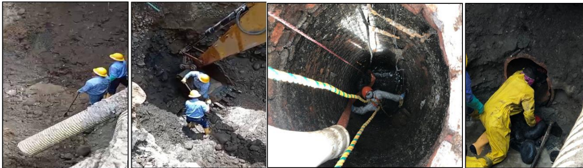
Foto 22 Atención emergencia por obstrucción tubería de 22"
