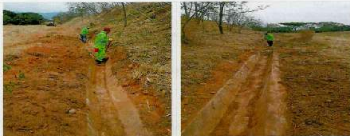
Canales perimetrales Manejo de Aguas Lluvia
