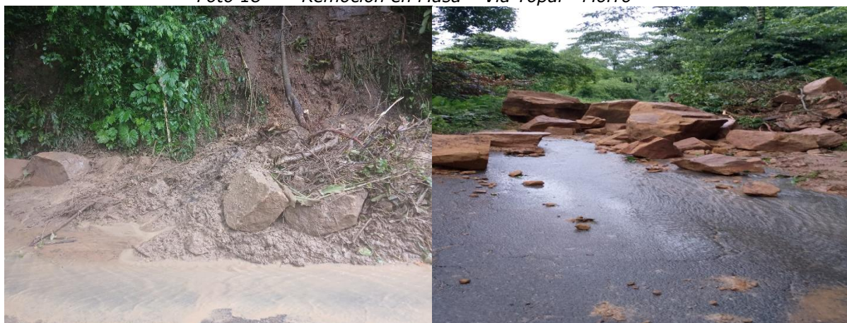
Foto 19 Deslizamiento y Caída de Rocas Vía Yopal - Morro
