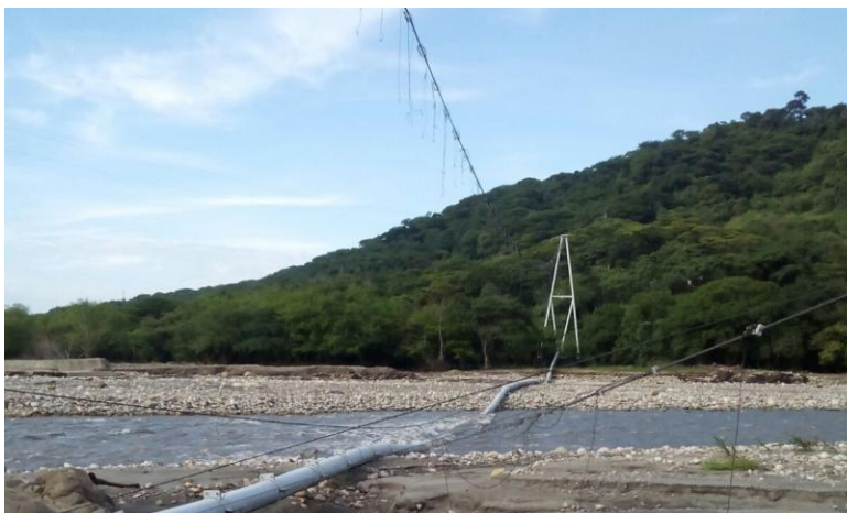
Foto 24 Colapso Paso Elevado año 2015, producto robo en elementos metálicos
