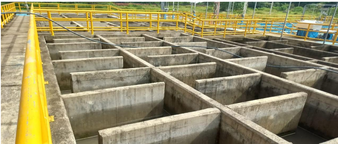
Foto 3 Sistema de Floculación
