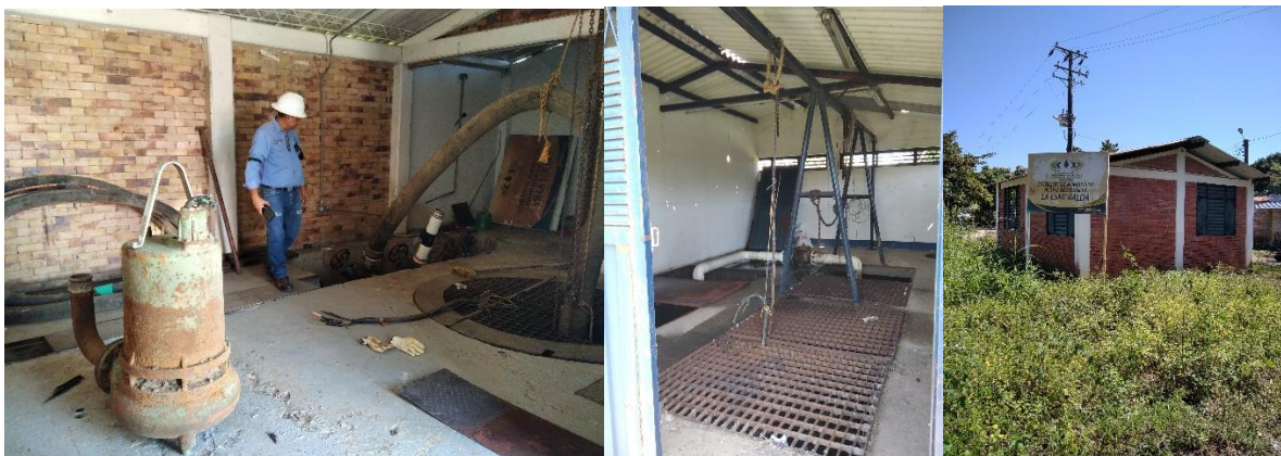
Imagen 22 Estaciones de bombeo de aguas residuales EBAR
