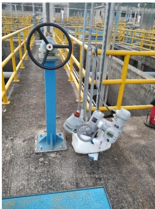
Imagen 10 Actuadores de apertura y cierre de compuertas de salida de filtro a tanques de almacenamiento en mal estado.
