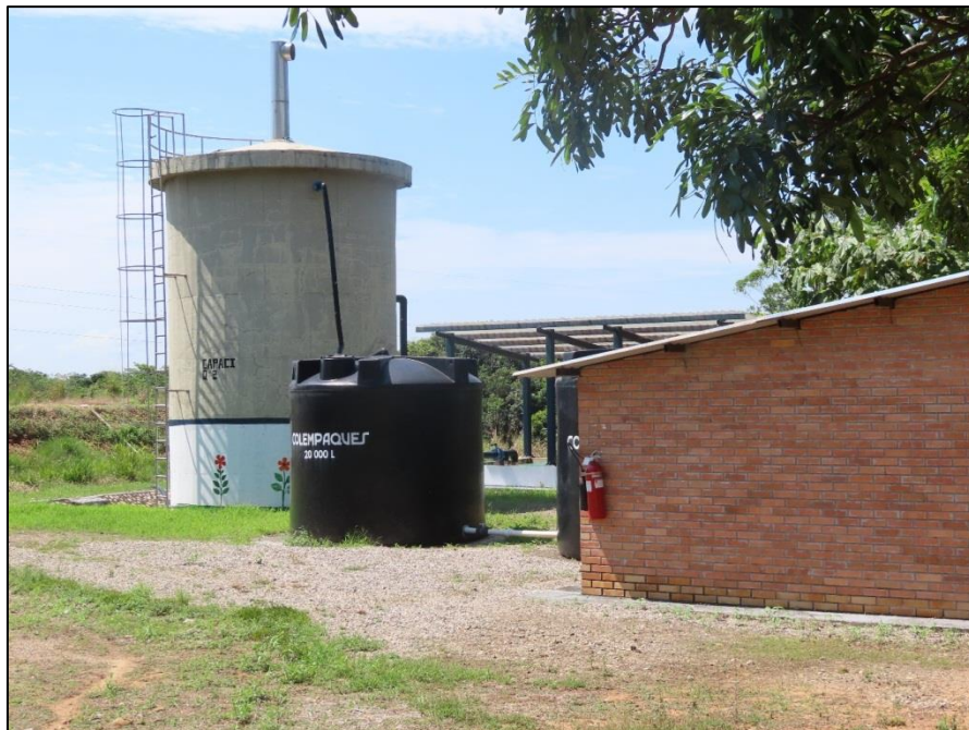
Imagen 33 Reactor UASB Relleno Sanitario El Cascajar
