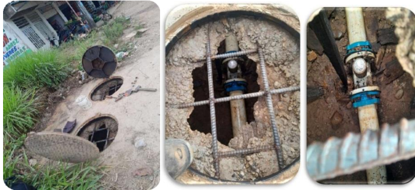
Imagen 34 Macromedidor Ciudadela La Bendición
