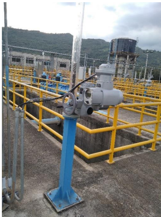
Imagen 9 Actuadores de apertura y cierre de compuertas de salida de filtro a tanques de almacenamiento en buen estado.
