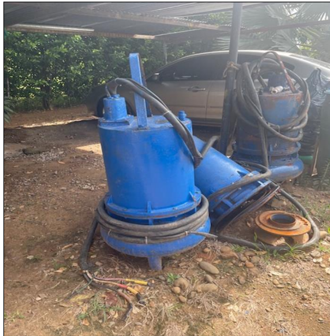
Imagen 25 Estado de bombas fuera de servicio
