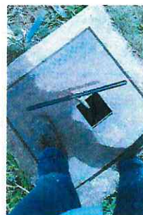
Válvulas de sectorización
