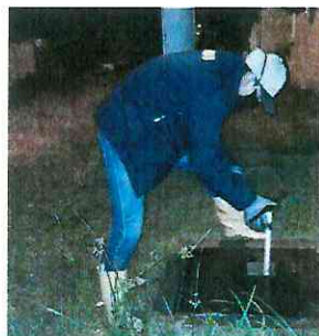
Movimiento de válvulas
