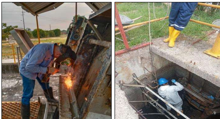
Ilustración 14 • Mantenimiento cribado manual y mecánico.
