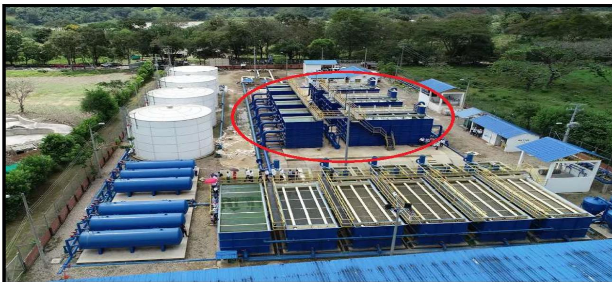
Foto 12 Planta 1 (Sistema alterno) de Tratamiento de Agua Potable
