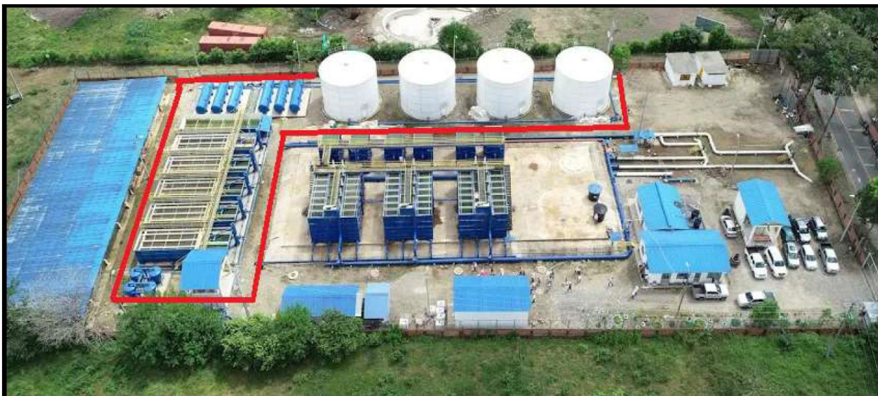
Foto 13 Planta 2 (Sistema Alterno) de Tratamiento de Agua Potable
