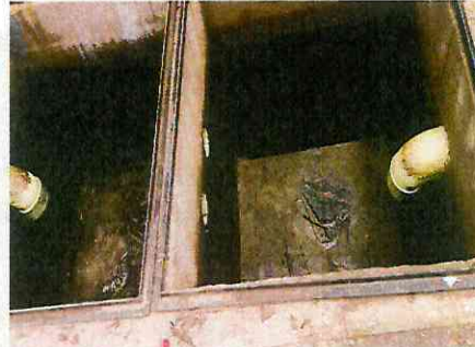
Almacenamiento trampa de grasas PTAR
