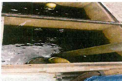
Trampa de grasas PTAR
