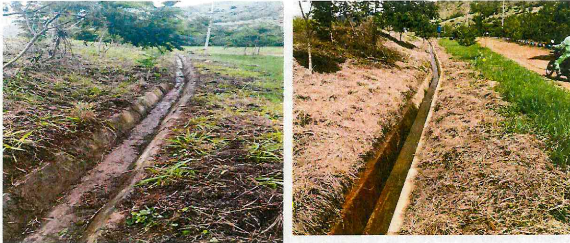
Canales perimetrales Manejo de Aguas Iluvia
