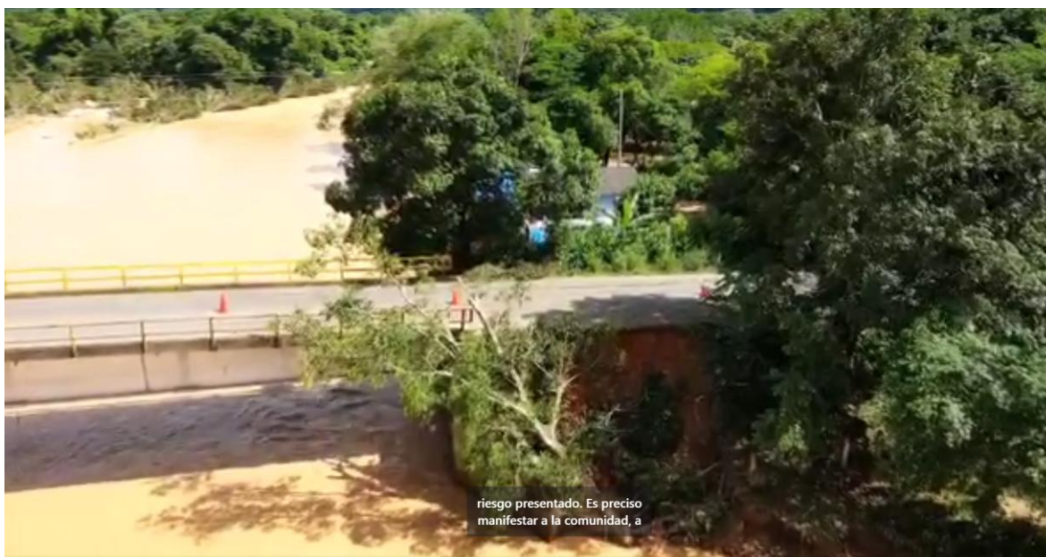
Foto 23 Socavación en Puente Sobre la Quebrada la Niata Producto de Avenida Torrencial
