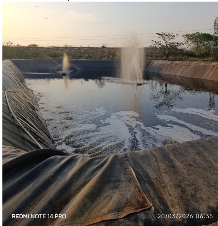
Foto 14 Aspersión interna en Piscina No 5
