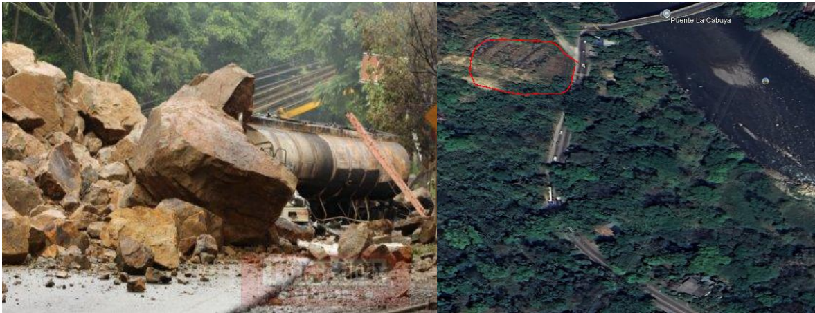
Foto 20 Caída de rocas antes de Puente La Cabuya sentido Yopal – Paz de Ariporo año 2019
